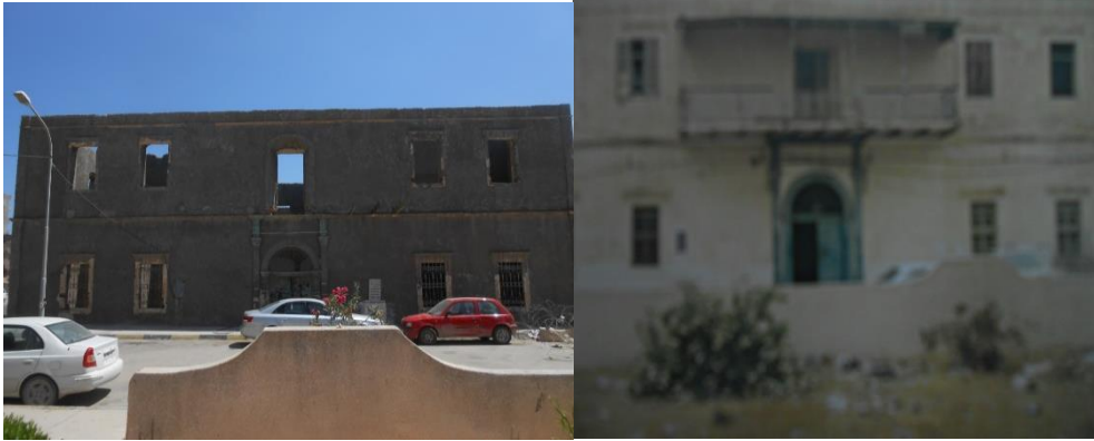
(أ) صورة توضح واجهة السراي قبل عملية التصليح صورة رقم (7) واجهة مبنى السراي .
